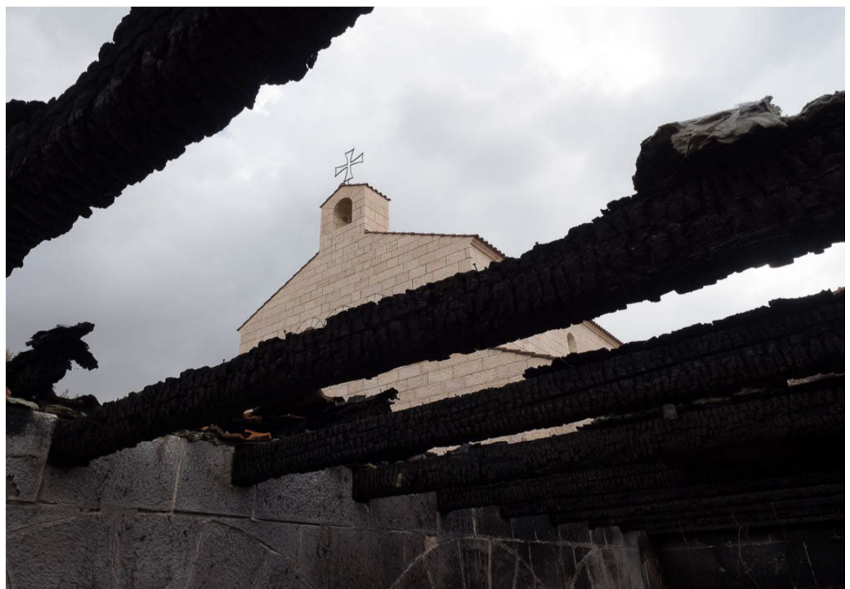
Kościół Rozmnażania w Tabgha, widoczny przez spalony dach budynku pomocniczego obok kościoła.
